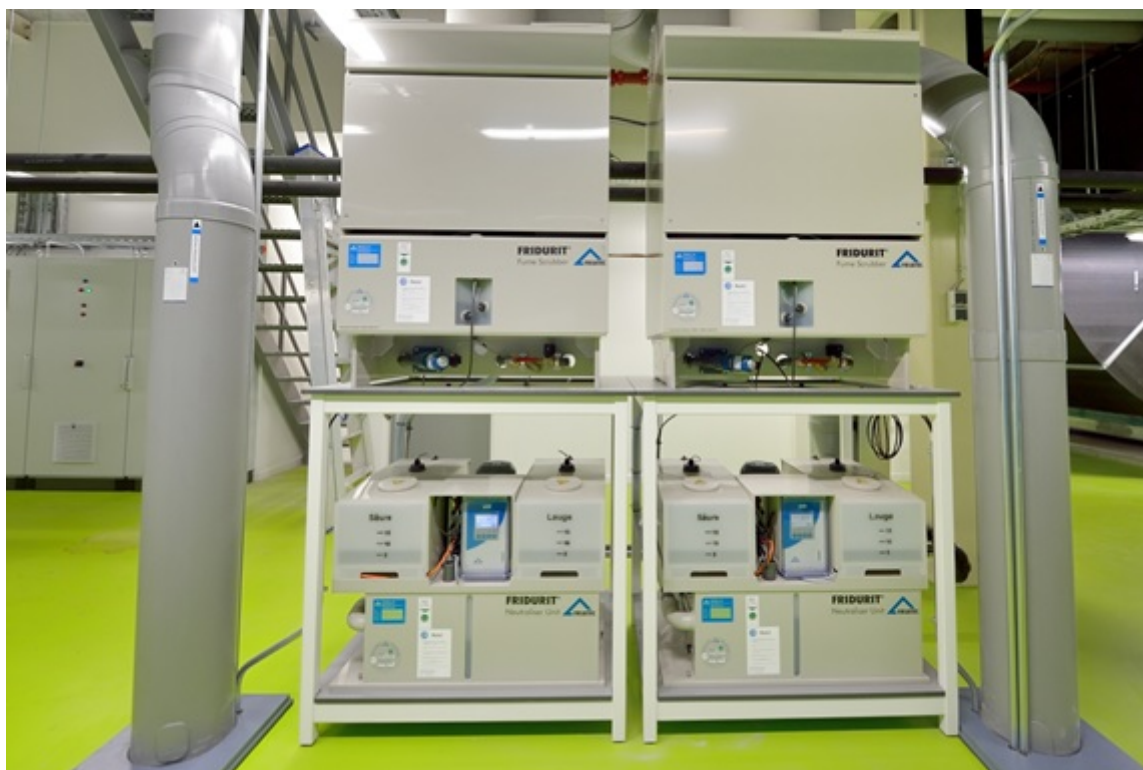
Zdj. Stacja neutralizacji oparów i ścieków
